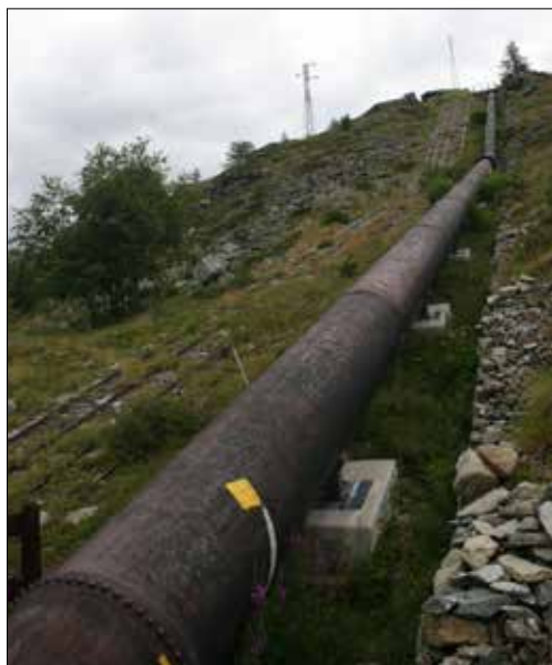
La condotta forzata che collega la centrale di Perrères con il Vertice
